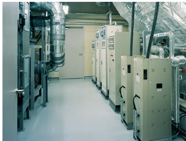
オゾン発生/分解システム機械室全景
